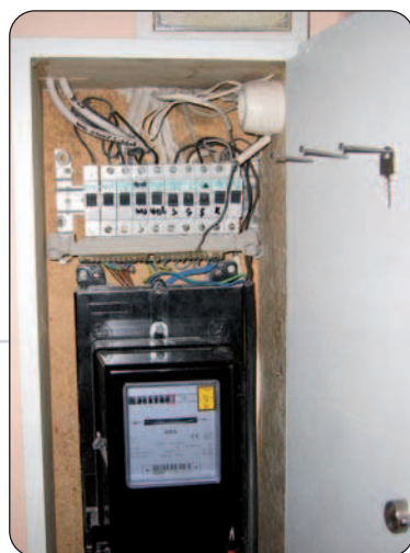
Bild 6: Zählertafel unzulässigerweise auf brennbaren Materialien montiert
