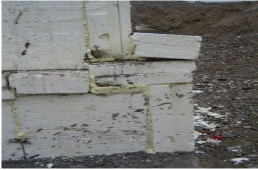
Bild 1: Polystyrol-WDVS im Perimeterbereich - schlampig und lückenhaft verlegt, Stückwerk statt fachgerechtem Plattenverbund
