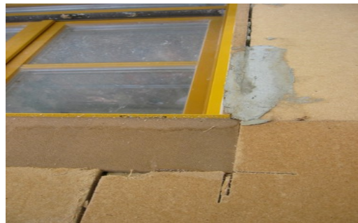
Bild 6: Holzfaser-WDVS schlampig verarbeitet und lückenhaft verlegt, kein fachgerechter Plattenverbund. Wärmebrücken!
