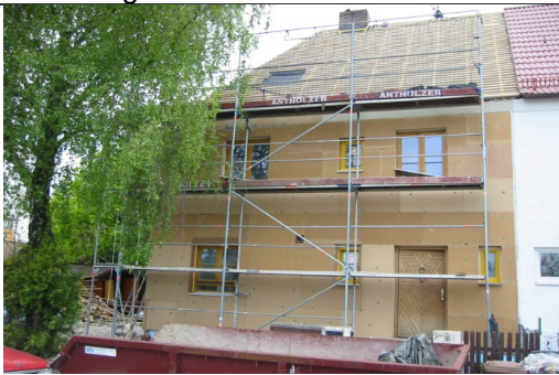
Bild 3: Brandschutzvorschriften missachtet! Holzweichfaser-WDVS (B2) wurde über die Brandwand geführt (siehe Brandschutz)
