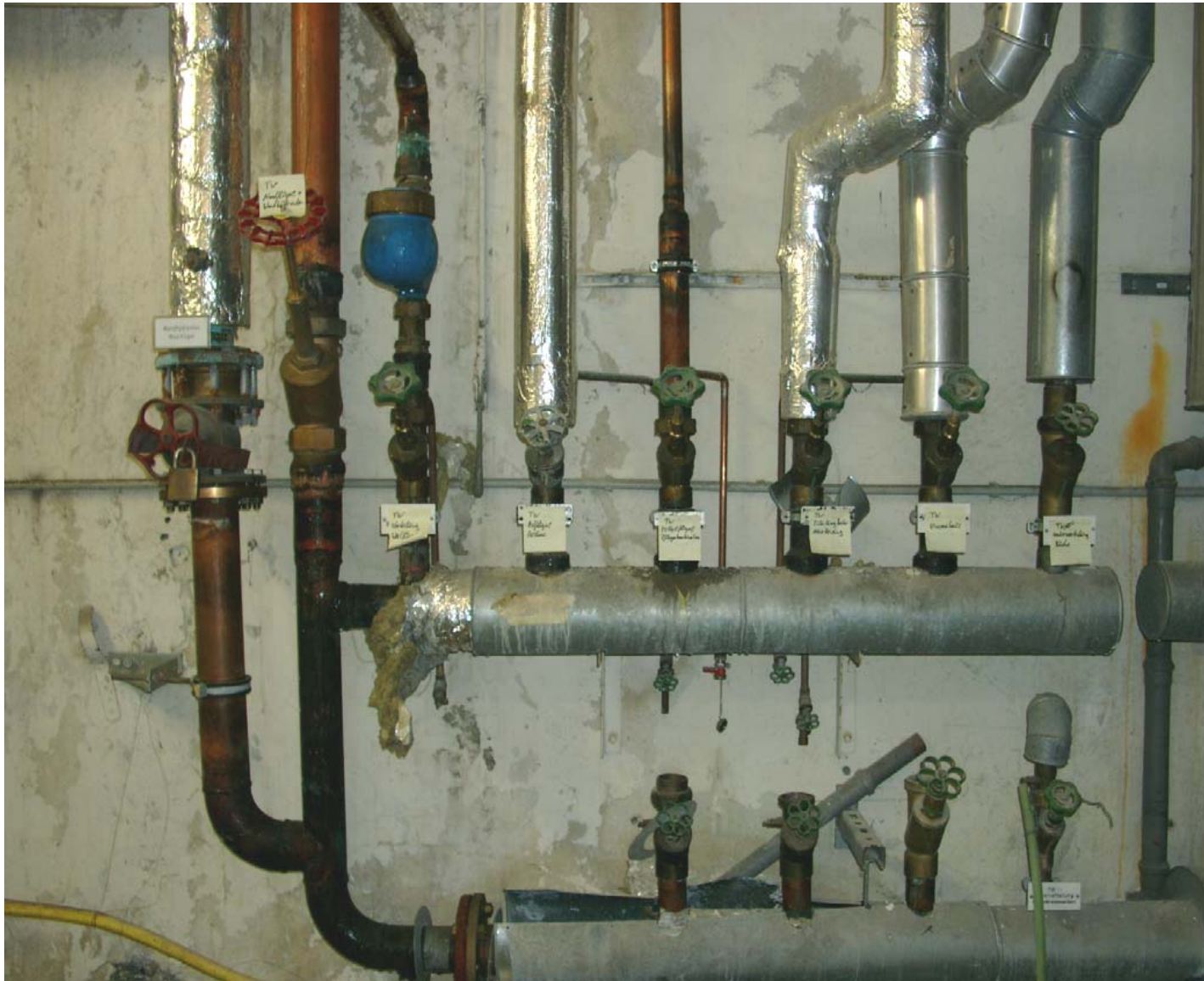
Trinkwasserverteiler, Stagnation und fehlende Dämmung
