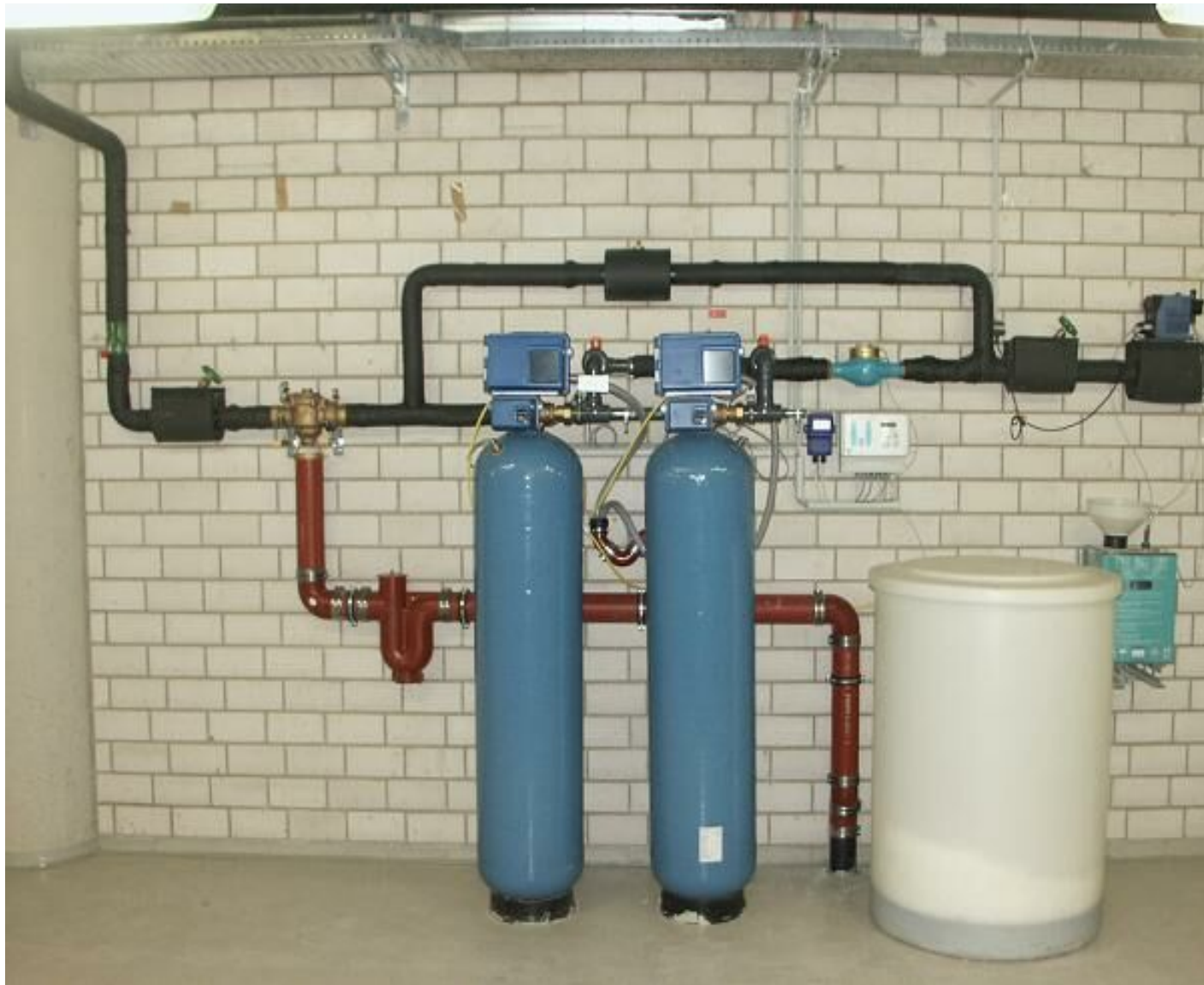
Umgehung Wasseraufbereitung, unzulässige Verbindung mit Entwässerungsleitung
