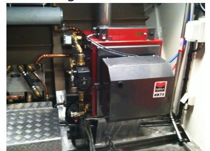
Heizung mit 40 kW Leistung
