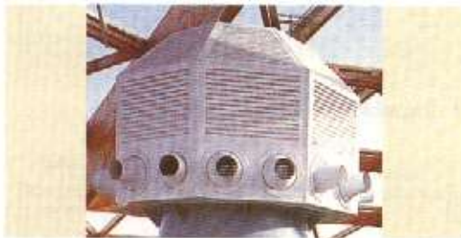
2. Weitwurfdüsen mit integrierten Abluftgittern
