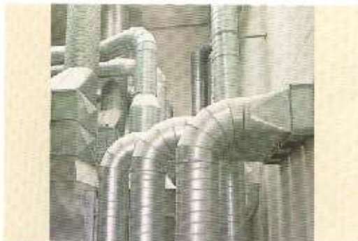
1. Einsatz von Wickelfalzrohren
