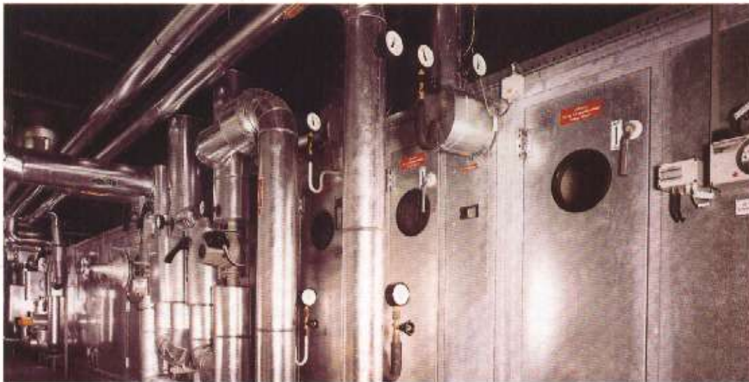
4. Zentrale einer raumlufotechnischen Anlage
