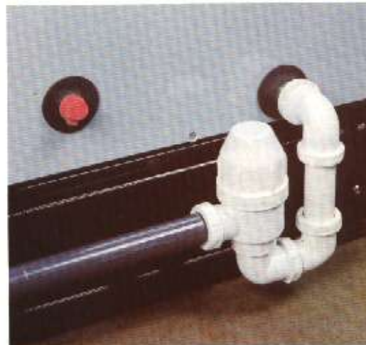
6. Luftkühler mit Kondenswasserwanne und Geruchsverschluss
