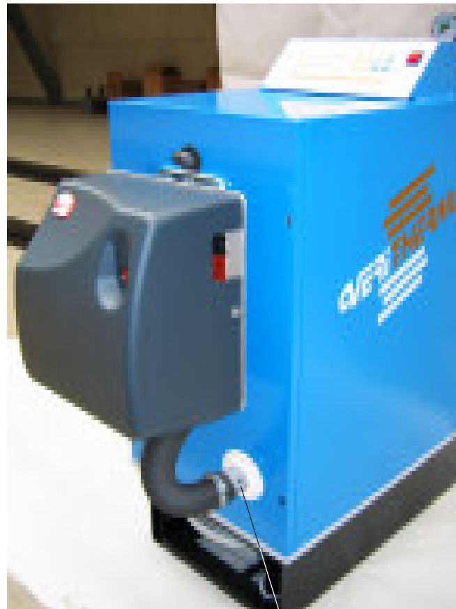
Messung der Verbrennungslufttemperatur
