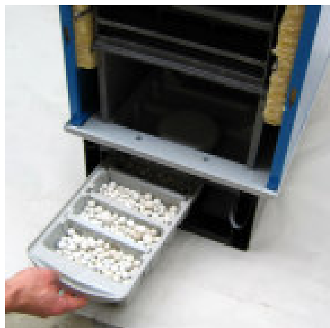
Bild 3-18: Kontrollieren der Neutralisationsanlage mit Granulatfüllung.
