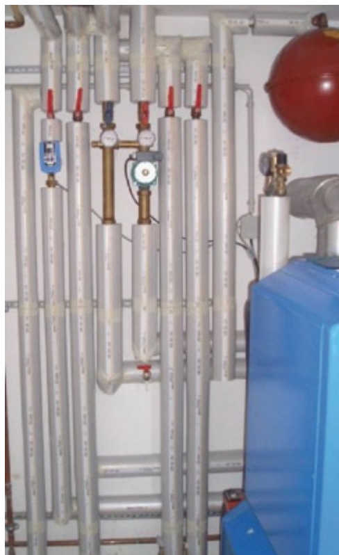
■ Abbildung 13 Die Rohrleitung ist mit Misselon-Robust der Kolektor Missel Schwab GmbH gedämmt, aber die Armaturen müssen noch nachgedämmt werden, erst dann kann eine Abnahme erfolgen.
