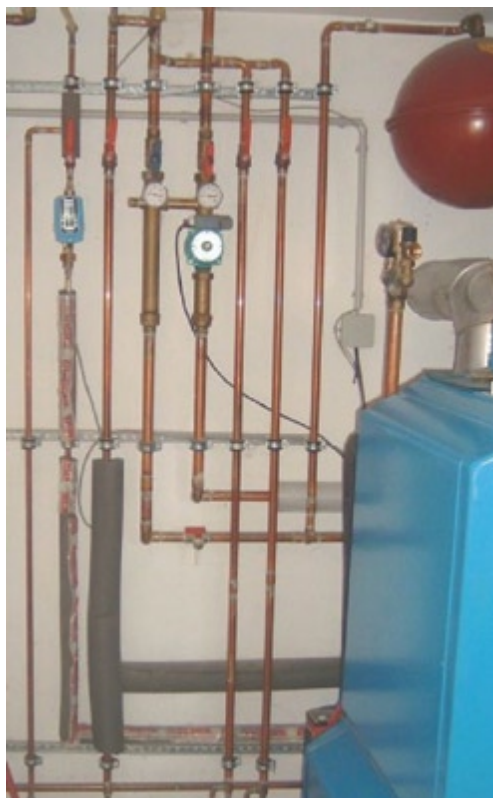
■ Abbildung 12 Fehlt die Dämmung an den Rohrleitungen oder ist sie unzureichend, ist das Werk noch nicht fertiggestellt und damit noch nicht abnahmefähig.
