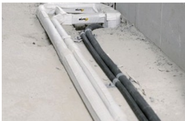
■ Abbildung 4 Eine saubere Arbeit, die auch den anerkannten Regeln der Technik entspricht. Die Verwendung von hochwertigen Materialien und Produkten auch für Rohrdämmungen, wie die Missel Kompakt-Dämmhülse von der Kolektor Missel Schwab GmbH, kann häufig entscheidend helfen, Mängel zu vermeiden.
