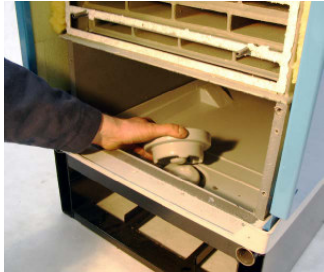
Bild 3-17: Inspektion/Reinigung von Bodenwanne und lose aufgesetzter Geruchsverschluss, zugänglich nach Demontage des Kunststoff-Wärmetauschers.
