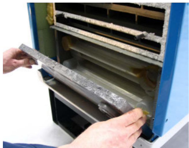
Bild 3-14: Abnehmen der Stützrahmen-Vorderwand zur Inspektion/Reinigung des Kunststoff-Wärmetauschers.
