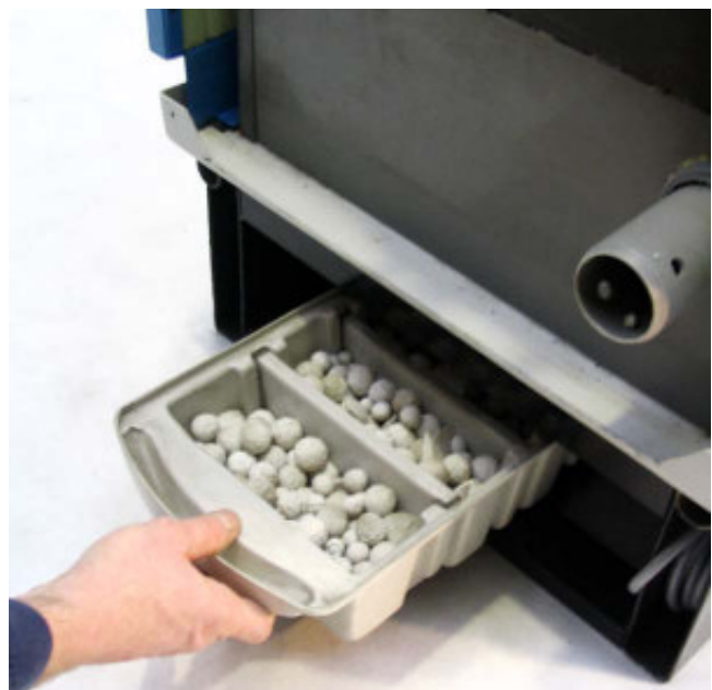
Bild 3-18: Kontrollieren der Neutralisationsanlage mit Granulatfüllung.
