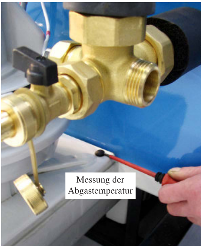
Bild 2-7: Messung der Abgastemperatur in der Bodenwanne an der Kessel-Rückseite.
