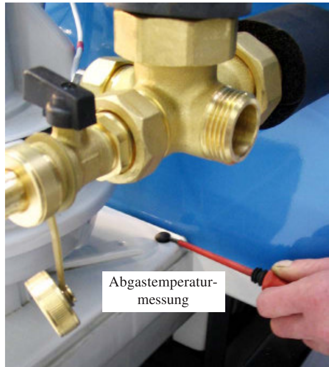
Bild 3-3: Abgastemperaturmessung in der Bodenwanne.
